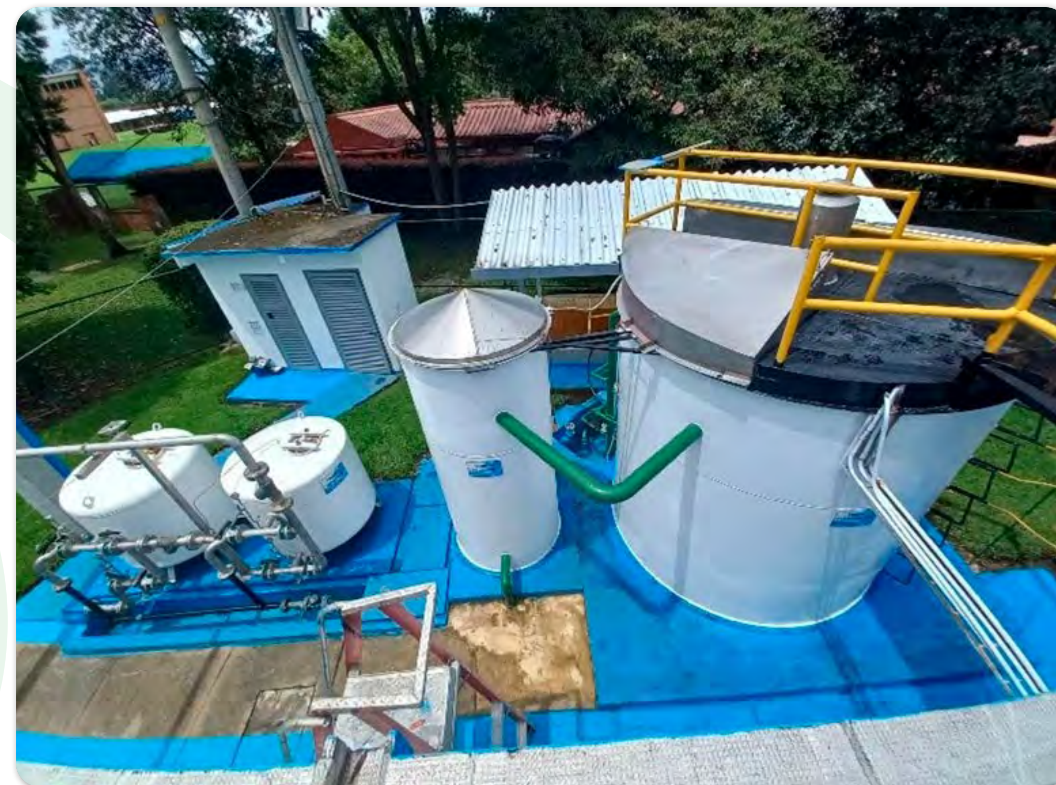
Foto: Planta de Tratamiento de Agua Potable Club Campestre Cafam Norte
